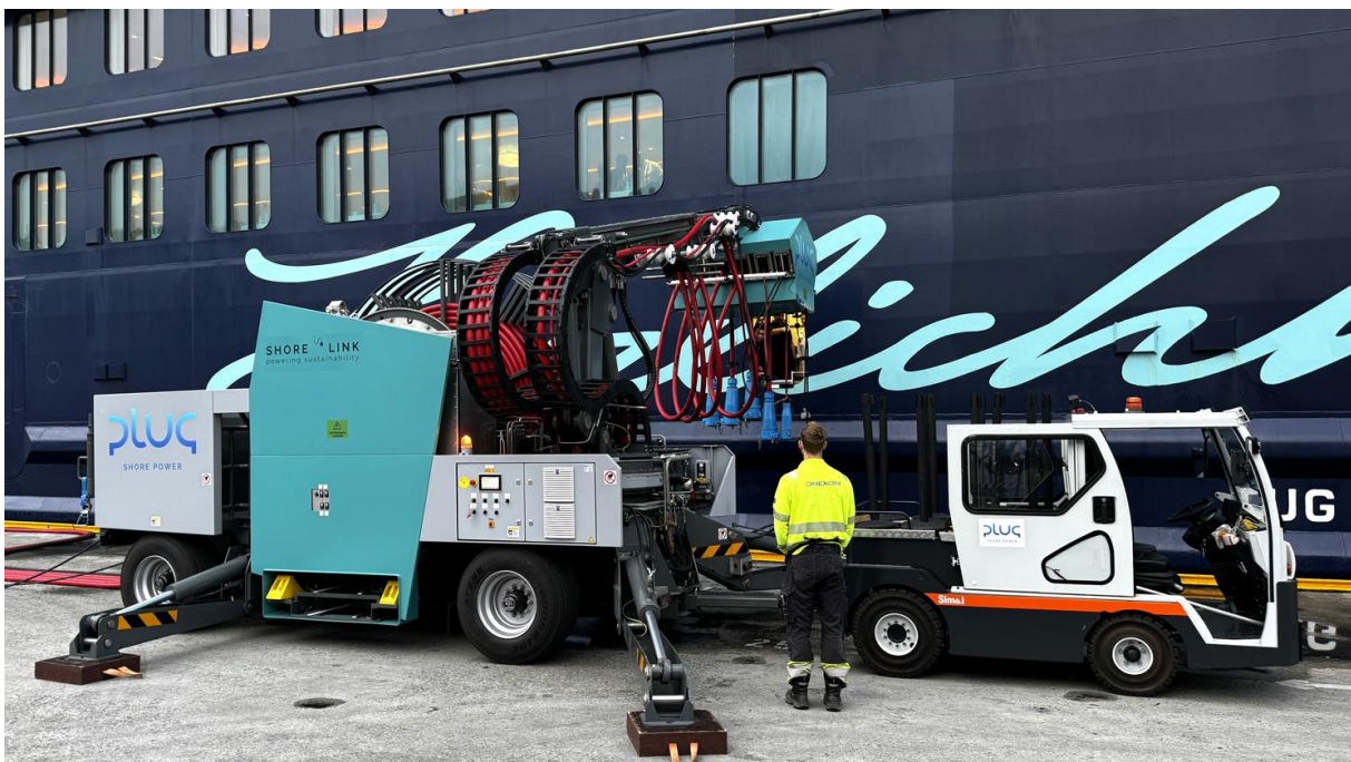
Nytt landstrømanlegg ved Sørsidekaiene i mai 2023.
